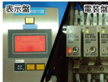
《漏水警報システム》
